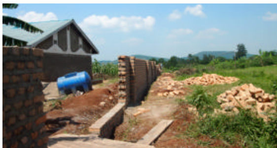
Anbau der vorläufigen Wohnräume für die Schwestern, sie sind mit einer Umfassungsmauer umgeben.
